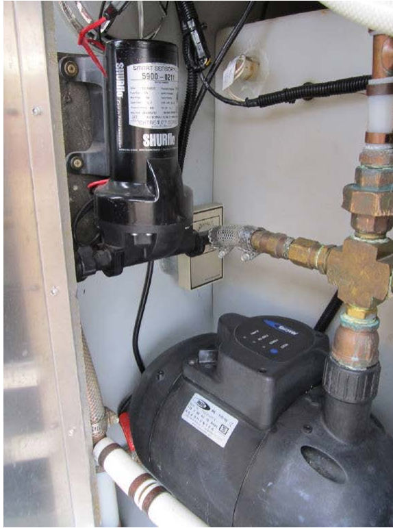
12 Volt water pump and 120 Volt water Pump
